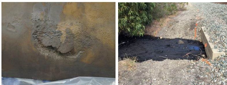
Gche : Vue du point de fuite sur la ligne (Source PHMSA) ; Drite : écoulement de brut visible au niveau d'un fossé du réseau de drainage (Univ. of California Santa Barbara)
