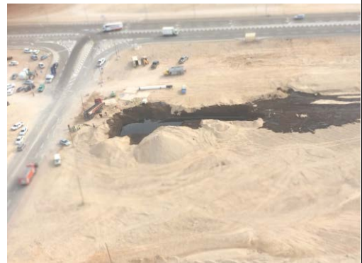
Vue de la brèche dans le pipeline Eilat-Ashkelon (Source : MCED )
