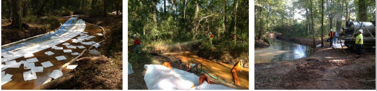
Collecte par absorbants divers (rouleaux, tapis, feuilles) (gauche) ; Rinçage localisé des berges par jets d'eau en basse pression (centre) ; moyens de pompage déployés à partir de petits véhicules chenillés (droite) (source : USEPA)
