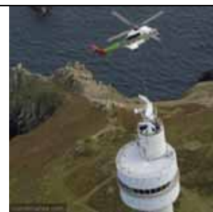
Installation par hélicoptère du nouveau radar de la tour du Stiff (Source : Marine Nationale)
