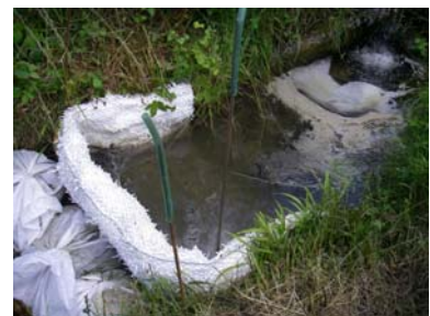
Barrage filtrant de fortune (absorbant en vrac + grillage agricole), ici maintenu par fers à béton (Source : Cedre)
