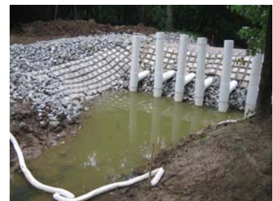
Dispositif filtrant : remblais et buses (Source : IEPA)
