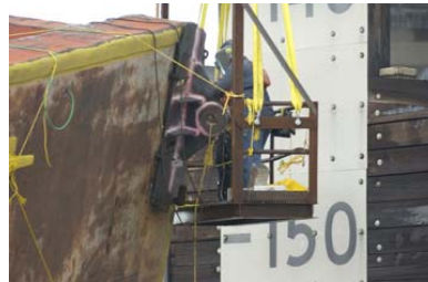
Soudure de points de levage sur la structure de la barge pour en permettre l'enlèvement par grues (Source : USCG)
