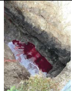
Flaque de fuel + absorbant en feuilles en fond de la tranchée (Source : Cedre)
