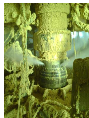
La tête de puits G4 d'Elgin : vue à la source de la fuite de gaz (Source : Total)
