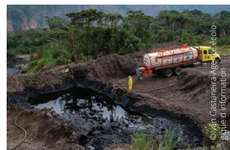
^ Confinement/collecte, par boudins absorbants, du pétrole brut dans des drains d'écoulement secondaires le long du ravin (haut) ; pompage (camion à vide) au niveau d'un point/fosse de collecte (bas)
