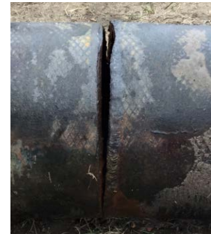
Vue de la brèche dans la conduite Poplar Pipeline, après son excavation en avril 2015 (source : Bridger Pipeline LLC)
