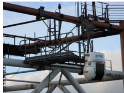
Le détecteur ( SensorPack ) installé sur la structure
