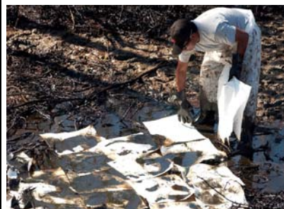
Récupération par absorbant sur le site de Bass Enterprises à Cox bay (source USCG)
