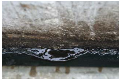
Fuite de la cuvette de rétention. (Source photos : Cedre)
