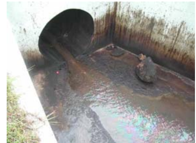
Exutoire de sortie des eaux pluviales du site, chargées en hydrocarbures.
