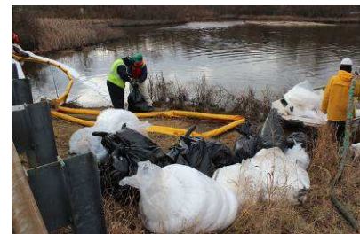
Confinement et récupération du gazole (source : gloucestertownship.patch.com)
