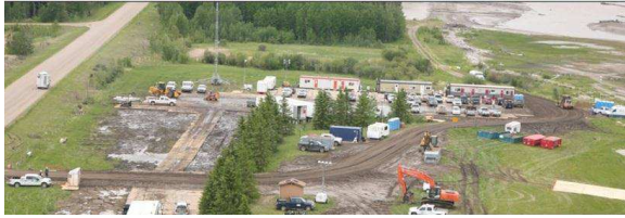
Vue aérienne du COD de Cottonwood, installé par Plains Midstream -juin 2012 (source : Plains Midstream)
