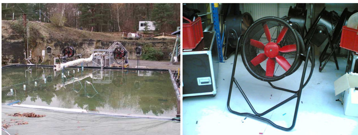
Figure A2 – 1 : installation des deux ventilateurs en amont du point de rejet
